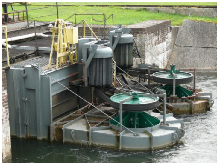
Rys. 17: Tylko przy dwóch szluzach funkcjonują elektrownie wodne.
